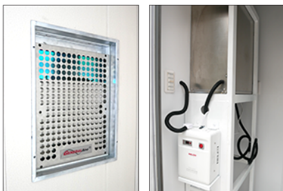
陰圧設備(左:室内/右:点検口から)
