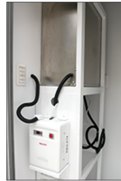
陰圧設備 左:室内 右:点検口から
