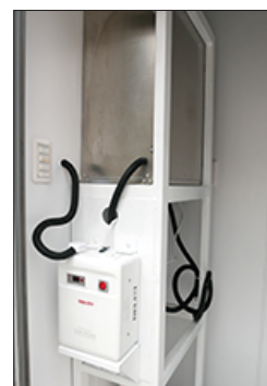
陰圧設備 左:室内 右:点検口から
