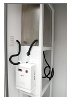
陰圧設備 左:室内 右:点検口から
